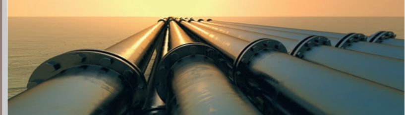
Brückentechnik Erdgas: Künftiger Großeinsatz zur Speicherung und Verteilung von Energie aus schwankender Erzeugung aus Erneuerbaren.
